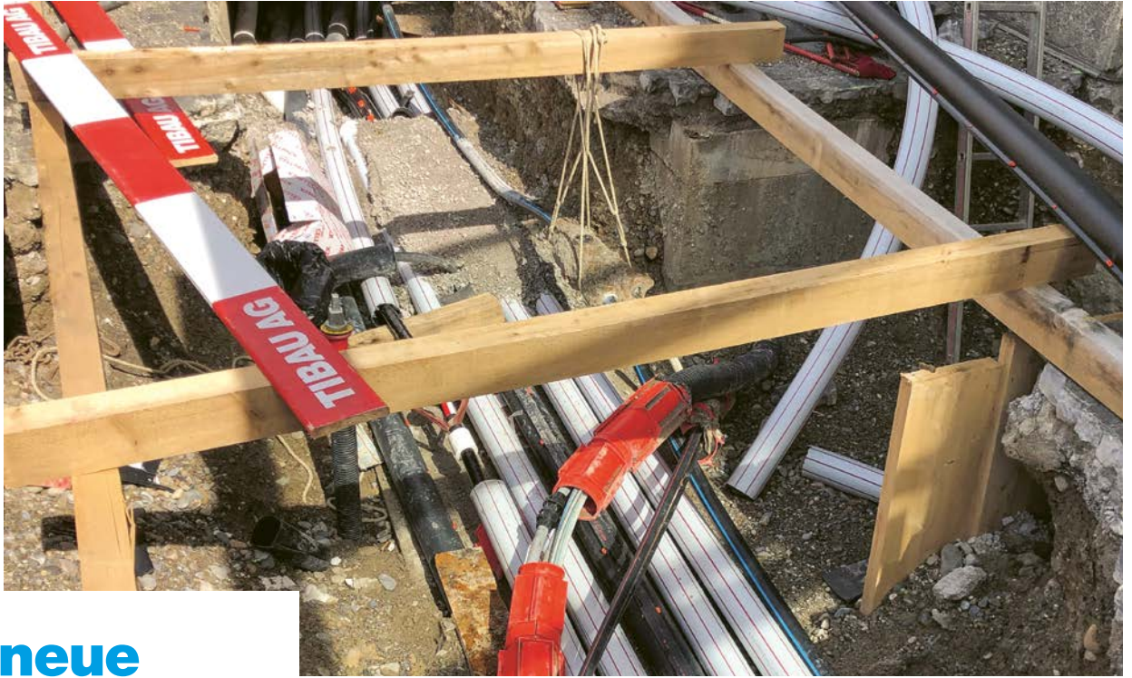
Typische Situation an einer Baustelle: Wer ist für die einzelnen Leitungen zuständig? Quelle: ARE
