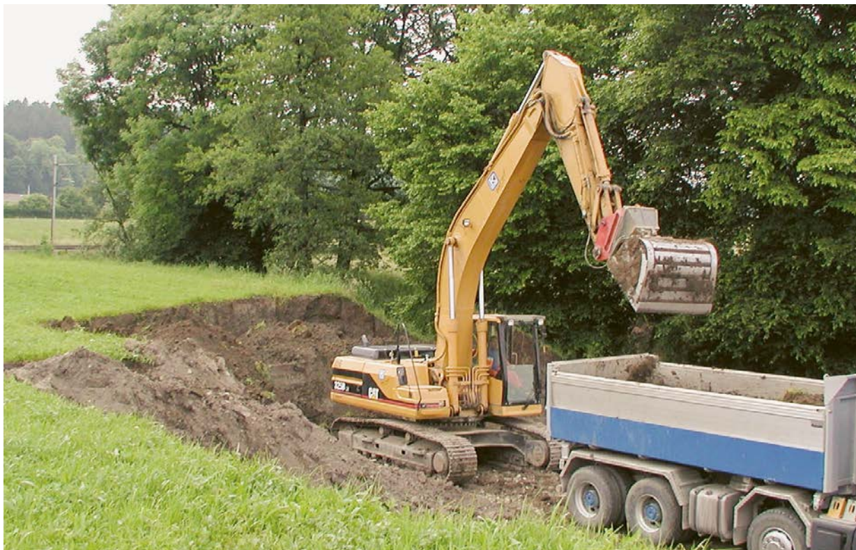
Werden Ober- und Unterboden abgetragen, sollen sie zeitnah am neuen Ort verwertet werden. Nicht immer ist dies möglich. Quelle: FaBo
