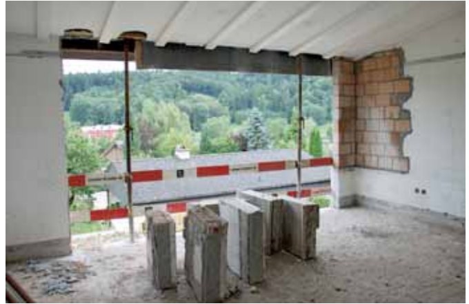
Der Blick durch raumhohe Fenster nach draussen wurde dank Dreifachverglasung energieeffizient möglich.
