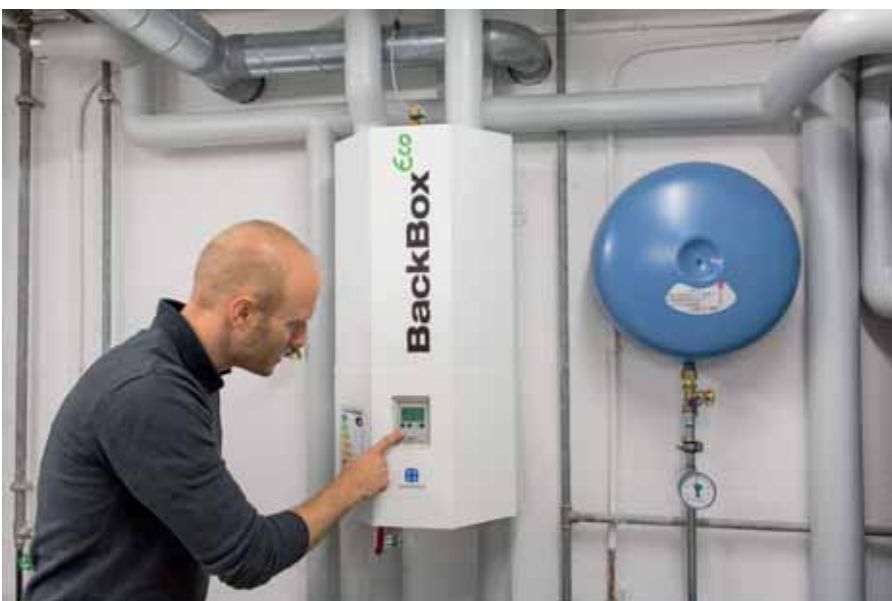
Das Herz der Anlage befindet sich im Keller. Die exakte Steuerung erlaubt Energieeffizienz – und begeistert Hausherrn Pascal Schmid.
