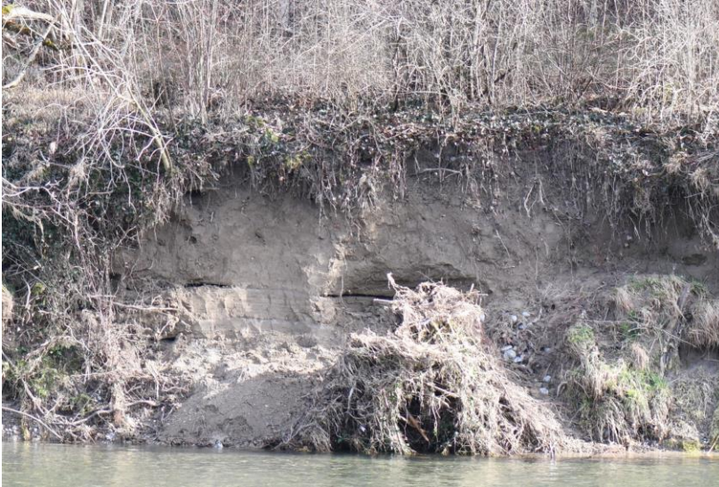
Abb. 8: Eine weitere steilere Abbruchstelle in der Wehri wurde im unteren Bereich senkrecht abgestochen und optimiert.
