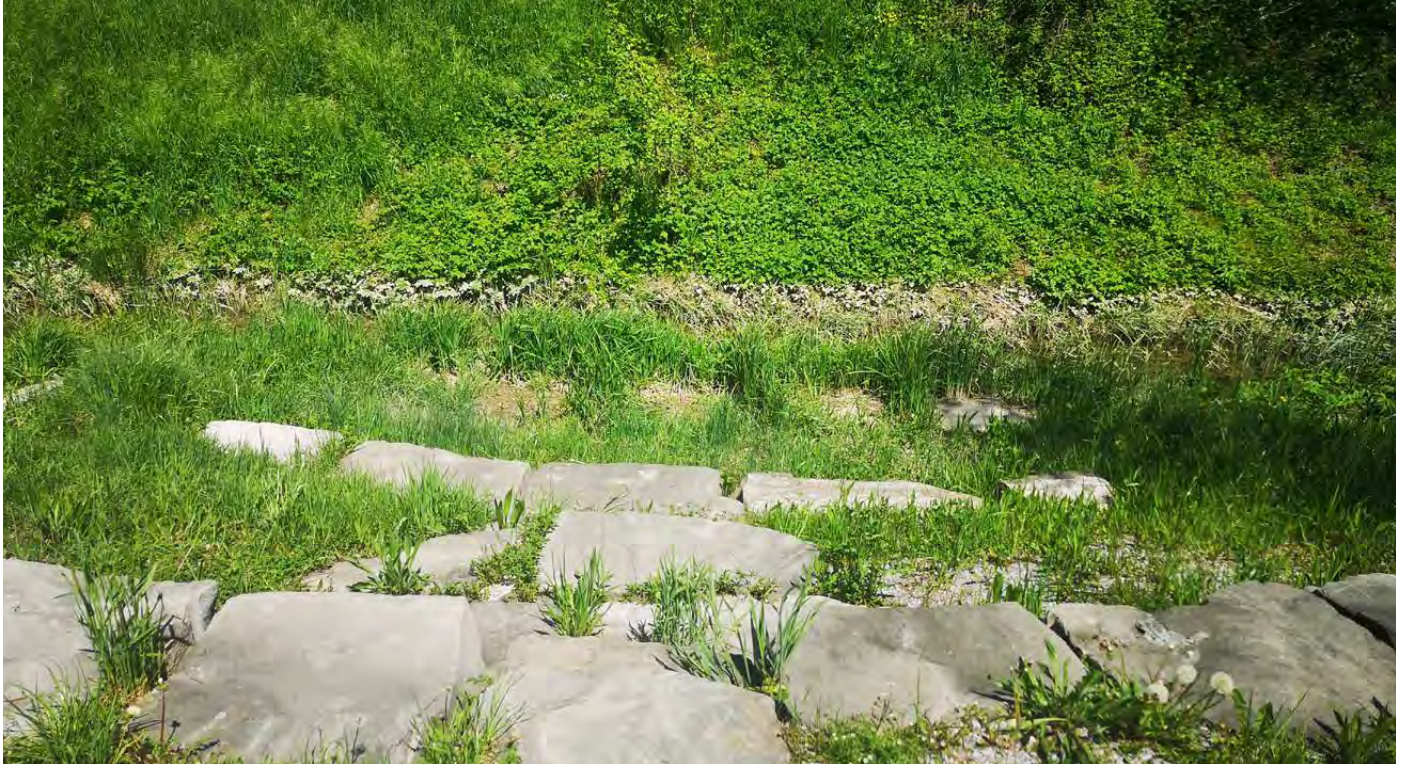
Sehr geringer Niederwasserabfluss im Hörnligaben in Dübendorf. Das Gewässer ist kaum sichtbar. Der Zugang zum Wasser verliert seine Bedeutung.
