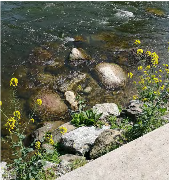
Vorgelagerte Schoppen (grosse Steine) zur Erhöhung der Strömungsvariabilität und zum Schutz vor Erosion in der Glatt beim Stadtpark Dübendorf. © AWEL
