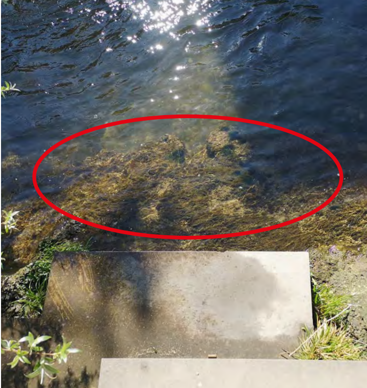
Unvollständig zurückgebaute ehemalige Uferverbauung aus Beton am Aabach im Zellwegerareal in Uster, die zunehmend unterspült wird. © AWEL
