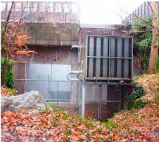
Kühlturm mit Einbringöffnung
