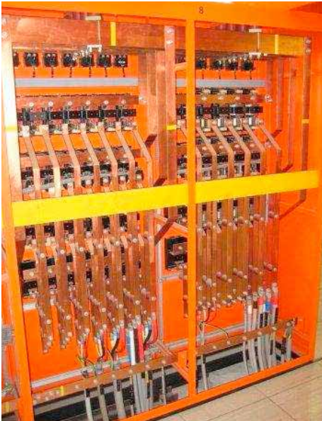
Bestehende Hauptverteilung von Hinten
