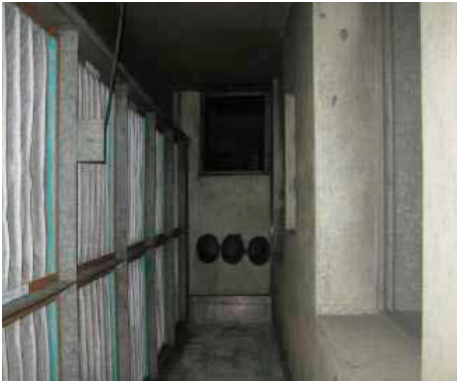
Plenum vor Filter
