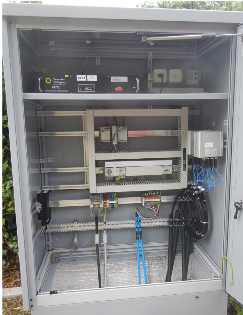
Abbildung 26: Einbau MIV- und Bike-Counter-Zählgerät in Kabine, siehe auch Einbau bei 2-teiliger Kabine (Abbildung 13)
