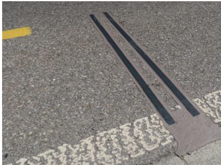
Abbildung 23: Im Strassenbelag eingebaute Sensoren (Radstreifen)
