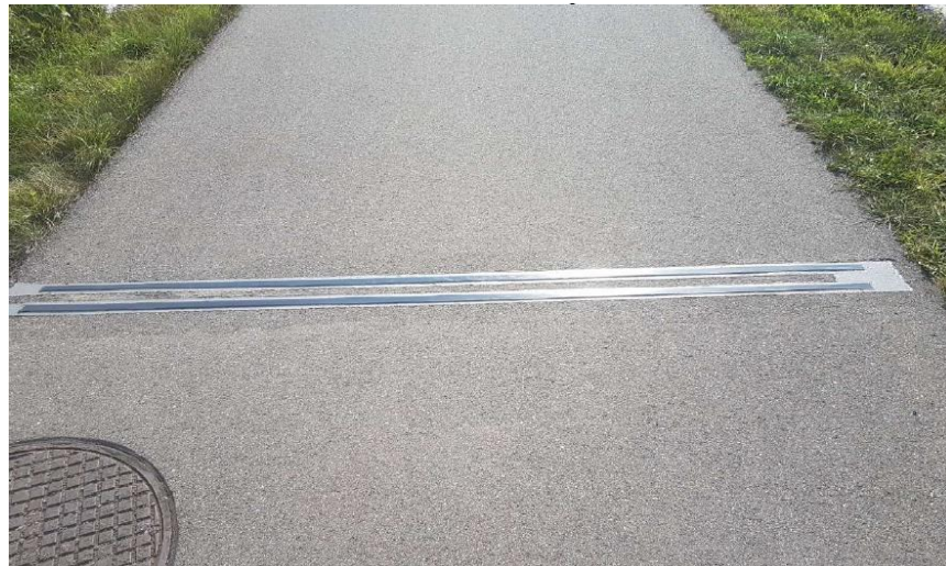
Abbildung 27: Im Strassenbelag eingebaute Sensoren A und B (hier in einem Radweg, Mindestabstand zu Detektorschacht von ca. 80 cm)
