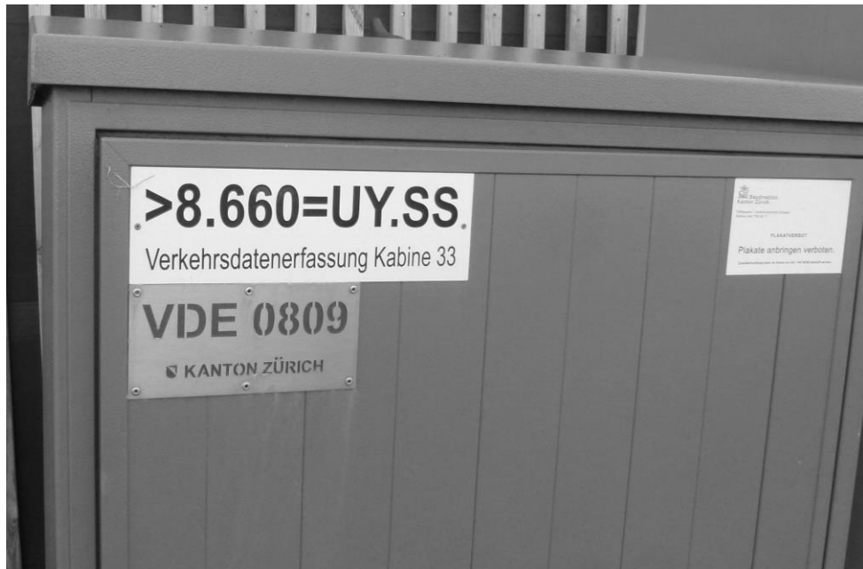
Abbildung 16: Beschriftung Messkabine kantonale Hochleistungsstrassen
