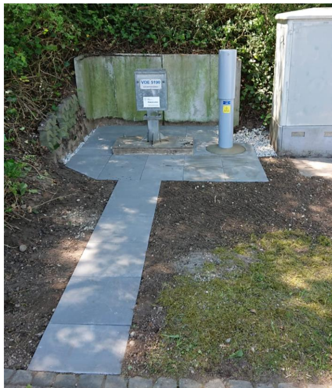
Abbildung 4: Bedienfläche und Zutrittsweg mit Betonplatten
