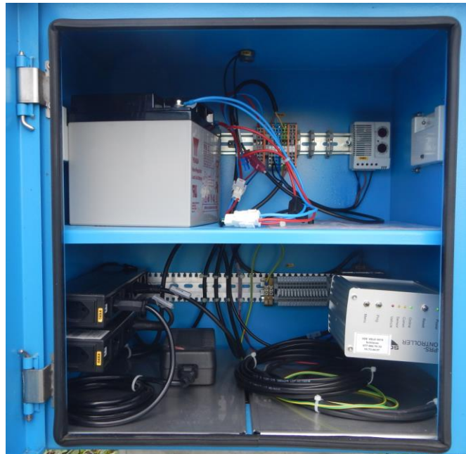
Abbildung 24: Einbau Bike-Counter-Zählgerät in Apparateschrank (Beispiel mit Zusatz-Akku bei Nachtstrom-Einspeisung)
