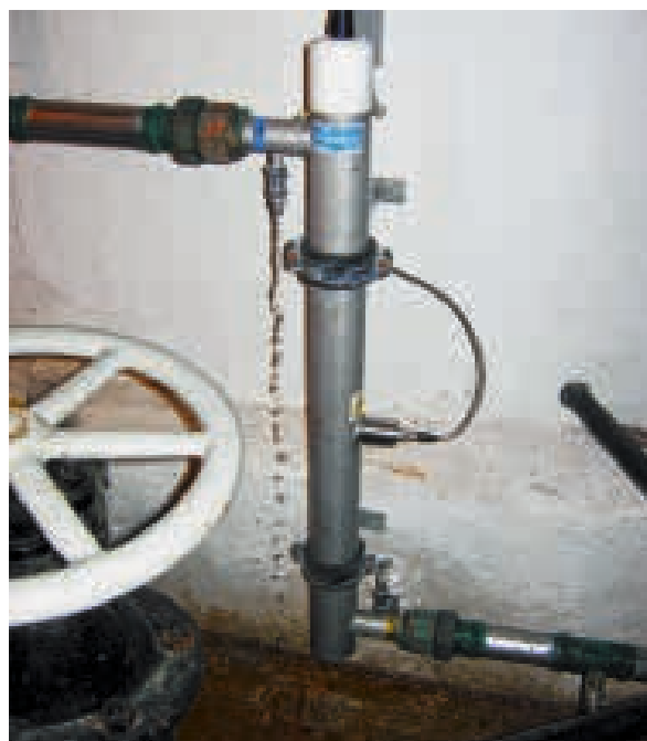
Abb. 8.2.2: Veraltete UV Anlage
