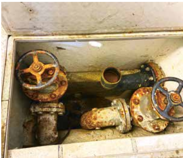
Abb. 8.1.1: Sanierungsbedürftige Entwässerung eines Reservoirs.
