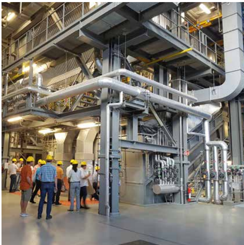
Energiezentrale der Städtzürcher Kehrichtverwertungsanlage Hagenholz.
