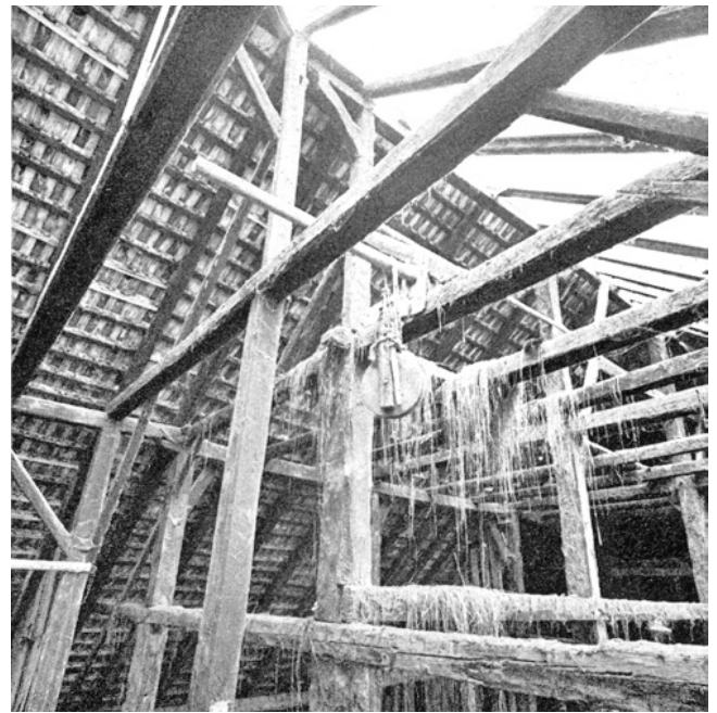
Affoltern. Im St. Blasienhof 12. Links das Dachgerüst des angebauten zweiten Wohnturmes. Dahinter der alte Dachstuhl mit später anstelle des Halbwalms aufgesetzter Firstsäule (über dem Spannbalken an dem das Rad hängt).
