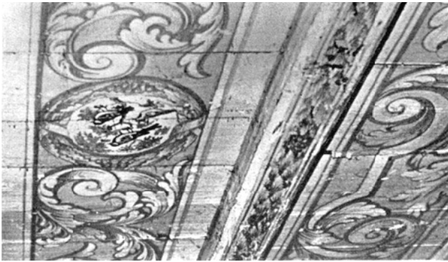
Meilen. Seestrasse 500. Landgut «Zur Seehalde». Bemalte Bretterdecke, während des teilweisen Umbaus 1959.
