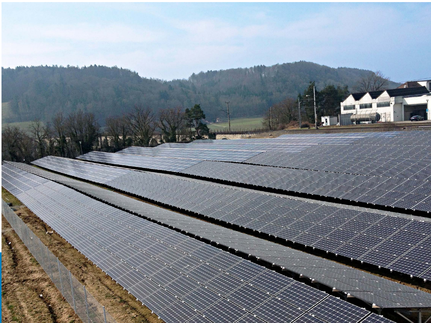
Freistehende Solaranlage, Eglisau, Industrie- und Gewerbezone
