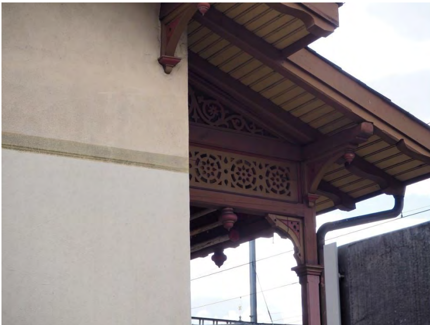
Stationsgebäude, Detail Laubsägeornamentik am westlichen Vorbau, 06.10.2017 (Bild Nr. D100668_34)
