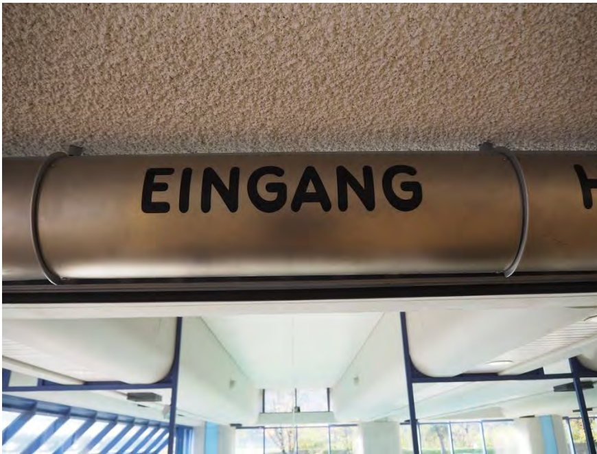
Sport- und Schwimmhalle, Beschriftung an technischer Installation, 01.11.2017 (Bild Nr. D101090_01)
