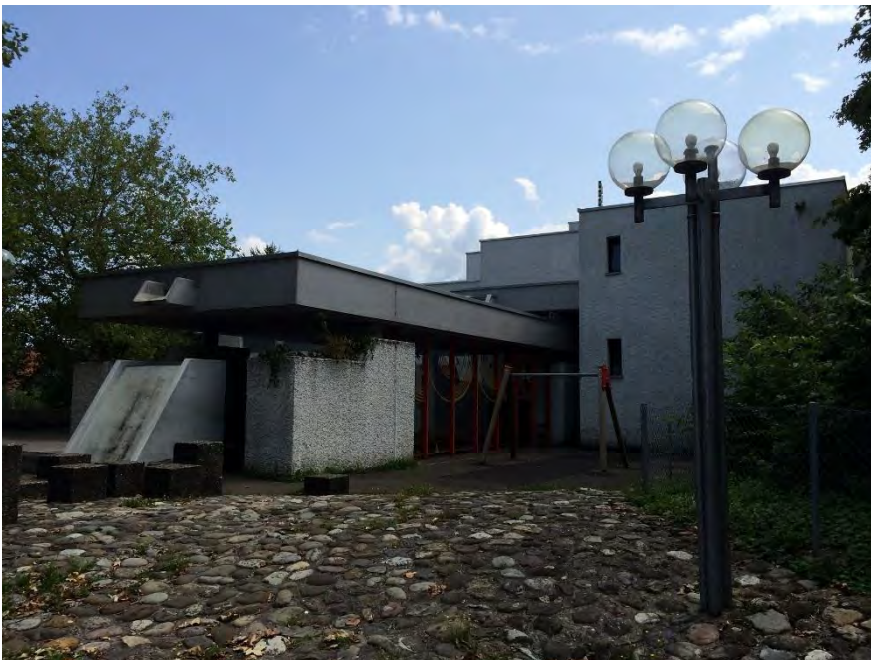
Primarschulanlage Fondli, Klassenzimmertrakt 1 (Vers. Nr. 02384) mit Pausenhalle und Brunnen, Ansicht von W, 05.08.2014 (Bild Nr. D100657_63)
