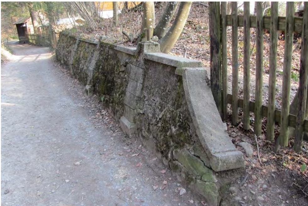
Klubhaus «Jurablick», Stützmauer mit Natursteinabdeckung nördlich der Hütte, 19.05.2015 (Bild Nr. D101131_14)
