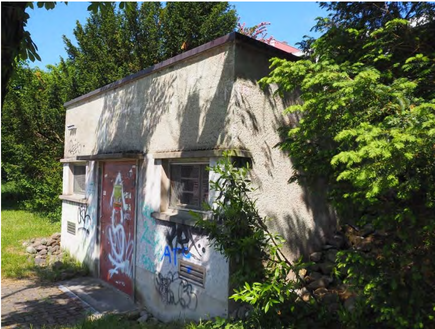
Gasreglerstation, Ansicht von SW, 08.05.2018 (Bild Nr. D100677_02)
