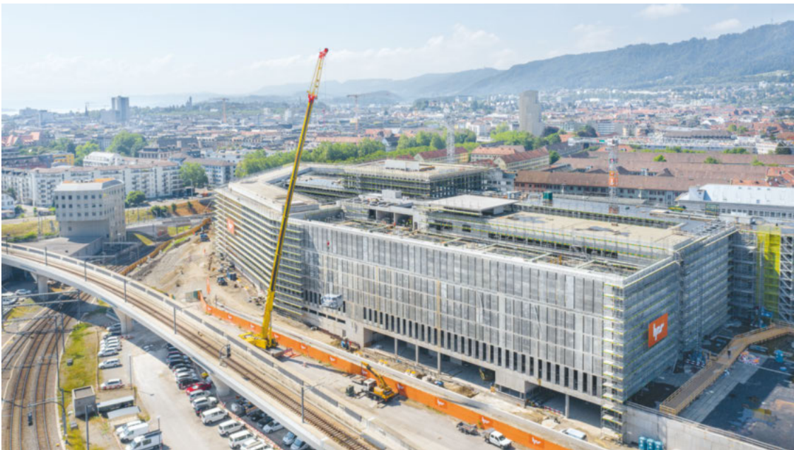
Stand des Baufortschritts des PJZ im Jahre 2019. Voraussichtlich 2022 werden die drei Kantonalen Staatsanwaltschaften sowie die Oberstaatsanwaltschaft ins PJZ umziehen.
